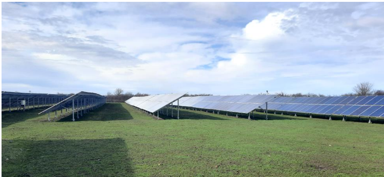
Fig. 3.7. Exemplu montaj centrala electrică fotovoltaică (CEF) pe teren
